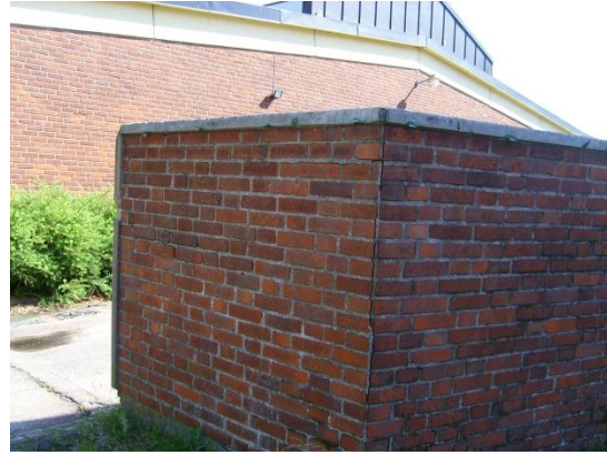
Bild 2: Tegelmur vid infart, skador i fogar
