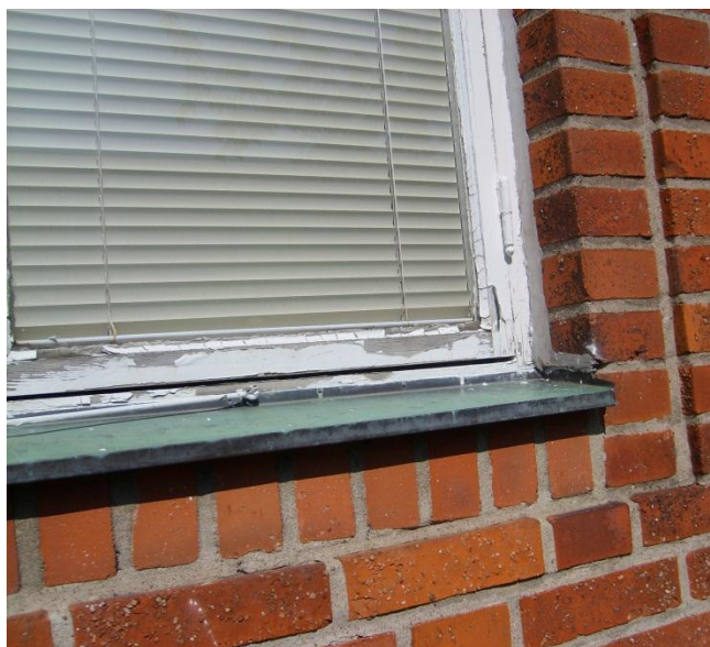
Bild 18: Bristande målningsunderhåll på fönster
