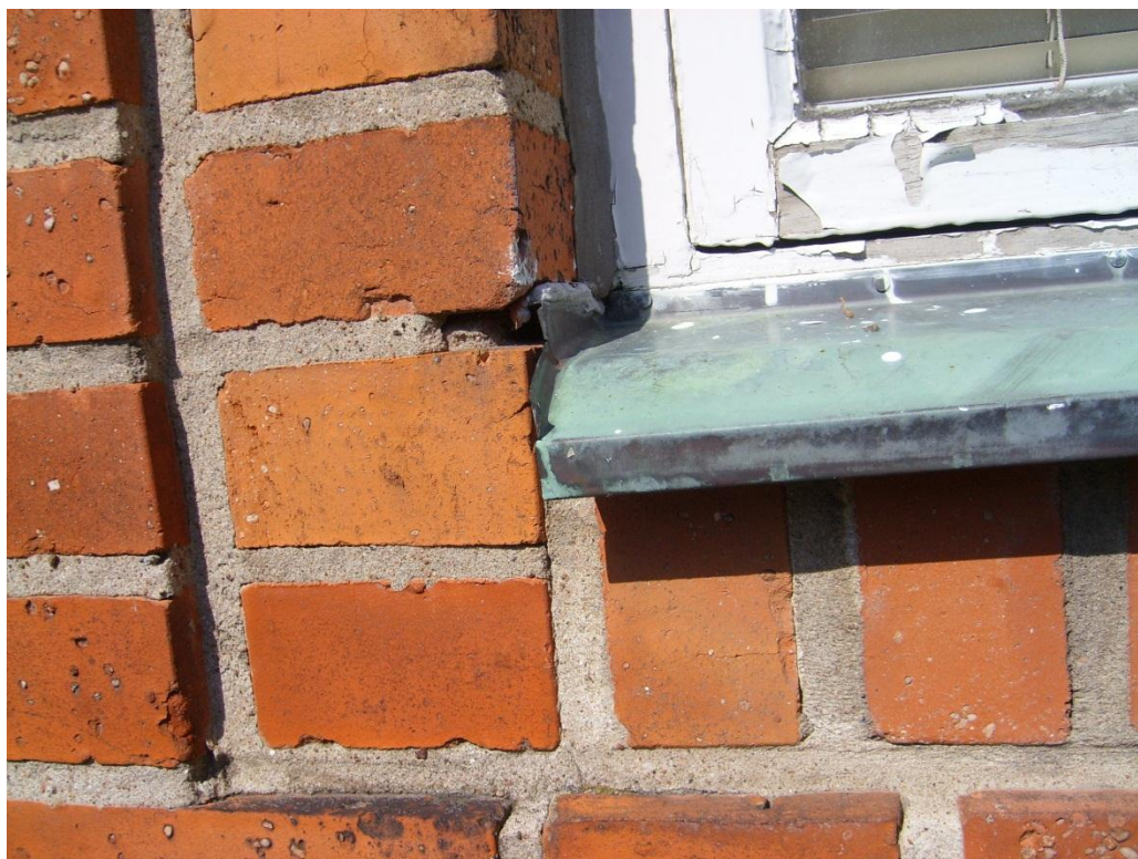
Bild 19: Bristande målningsunderhåll på fönster
