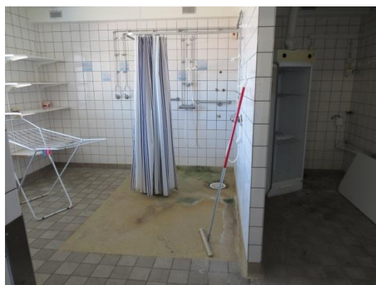
Massagolv vid duschar är av senare datum och misstänks inte innehålla PCB
