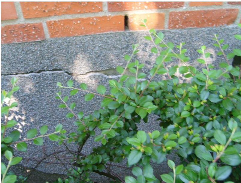
Bild 24: Sockelputsens borta, betongväggen är synlig
