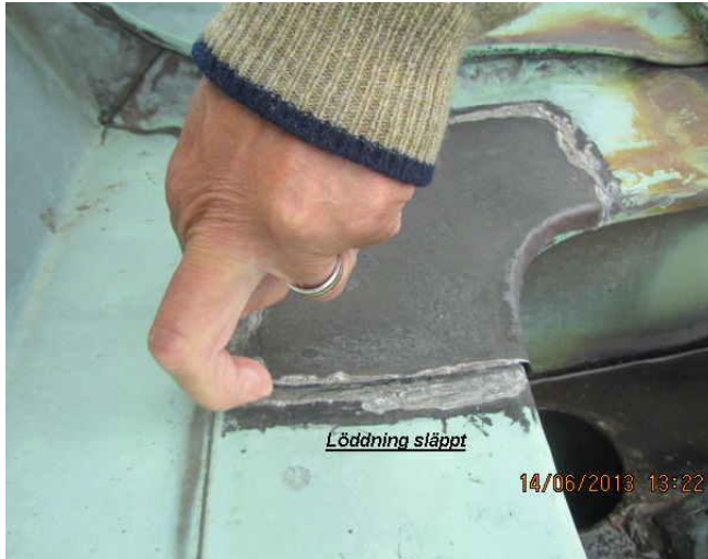
Punktvisa skador - dålig lödning
