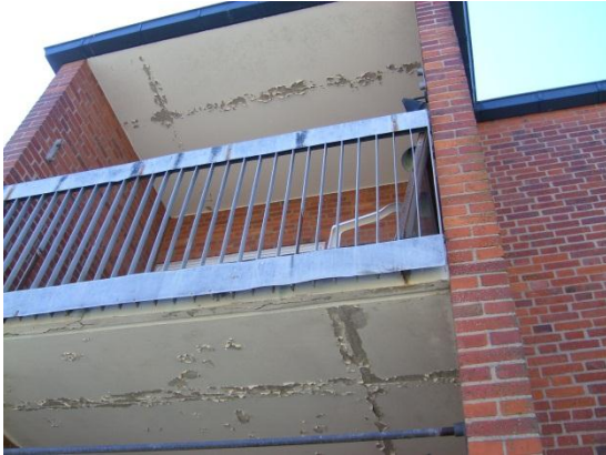
Bild 1: Takytor på balkonger är i behov av rengöring och målning
