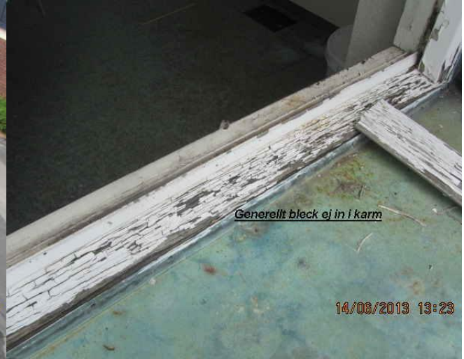
Bleck ej infällt i karm vid öppningar på tak.
