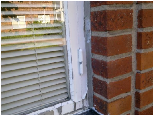
Fogmassa kring fönster har provtagits. Innehåller endast mycket lågt halt PCB
