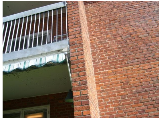
Bild 14: Sprickor och fogskador
