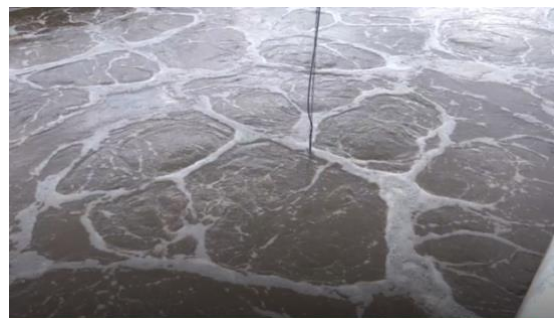
Figur 10 Luftningsbassäng vid Västra strandens reningsverk
