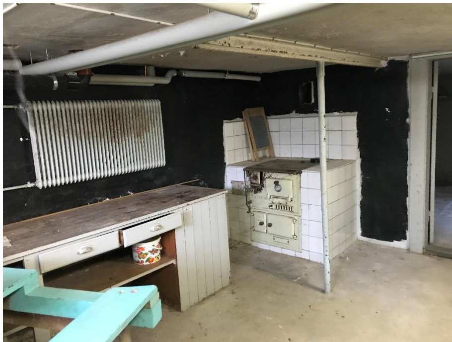
Figur 24. Källaren under den äldre byggnadskroppen är troligen byggd i efterhand och det gamla träbjälklaget är förstärkt med stålbalkar och pelare.
