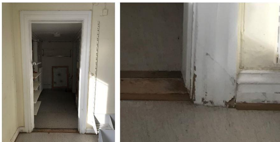
Figur 22. I den äldre byggnadskroppen finns dörrfoder och golvssocklar från 1930 eller äldre.
