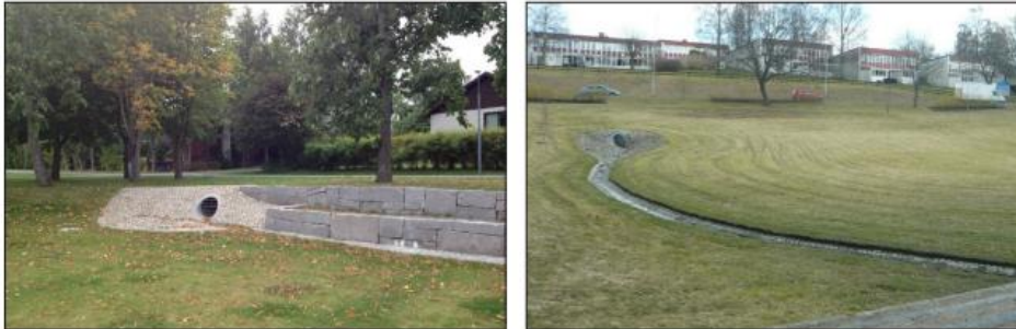
Figur 13 Torra dammar med inlopp och ränna (Svenskt Vatten Rapport Nr 2019-20, 2019).
