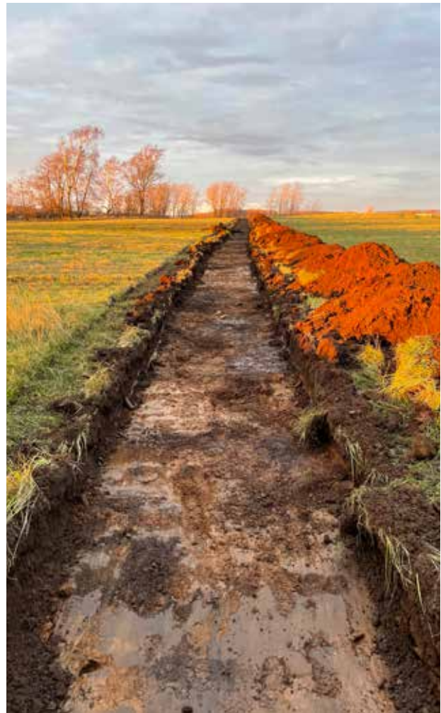
Figur 6. Översikt över schakt 1773, i höstsolen. Matjorden är cirka 0,3 meter tjock och undergrunden består av grusig sand med få stenar. I schaktet mättes 25 anläggningar in. Mot norr. (Fotonr. 2024-1-79). Foto: Linda Wigert.
