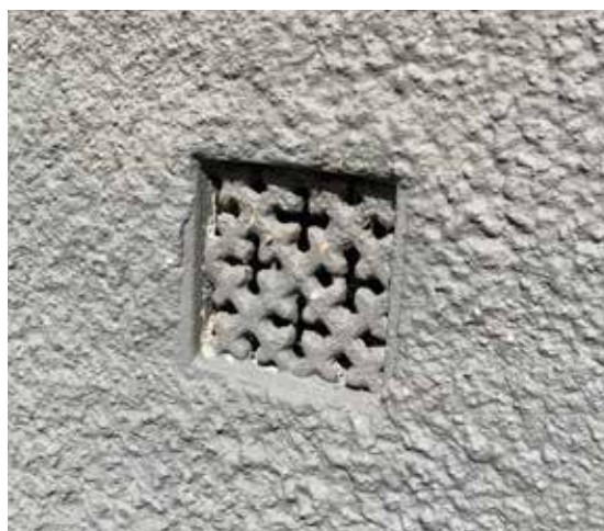
Vackert gammalt ventilationsgaller i gjutjärn i grundmuren.
